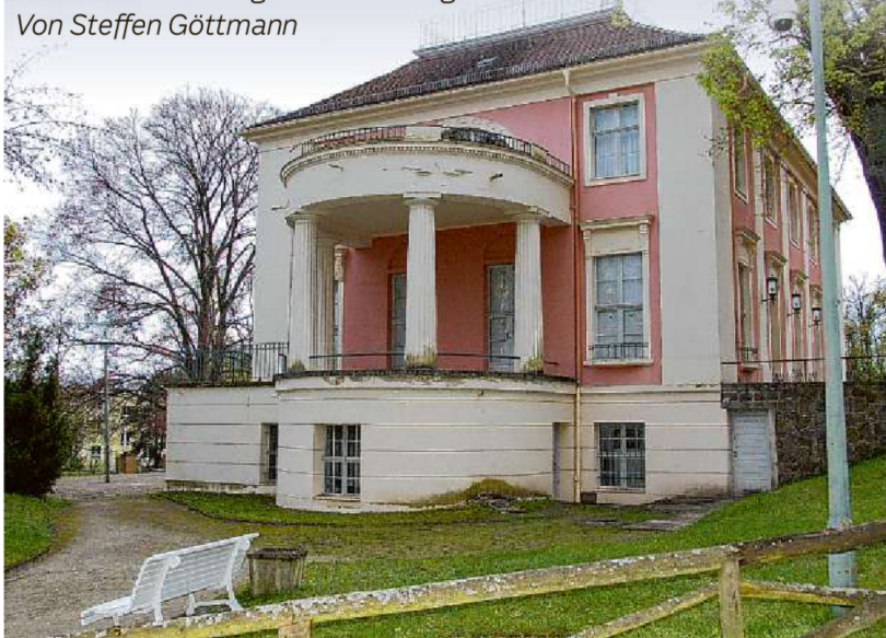
Besitzerwechsel: Der Putz am Schloss Freienwalde bröckelt. Der neue Eigentümer hat viel zu tun.
