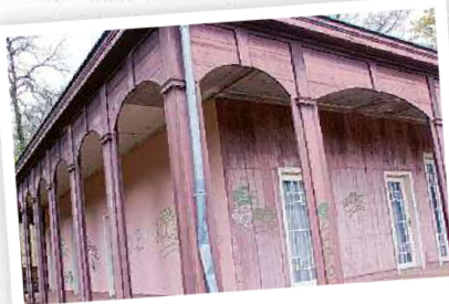
Kein Aushängeschild mehr: Das Teehäuschen am Schloss Freienwalde mit eingetretener Dachrinne und Graffiti.
